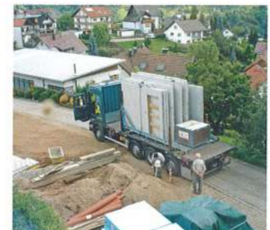
Die einzelnen Wandelemente eines Fertiggkellers werden im Werk vorgefertigt und per Lkw auf die Baustelle transportiert. Foto: Bürkle Kellerbau
