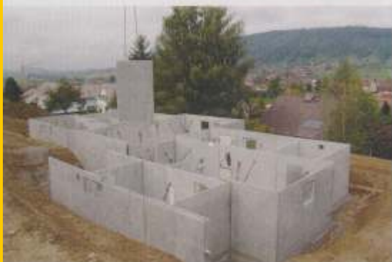
Die Kellerwände werden per Lkw auf die Baustelle gebracht und innerhalb eines Tages zusammengesetzt.
